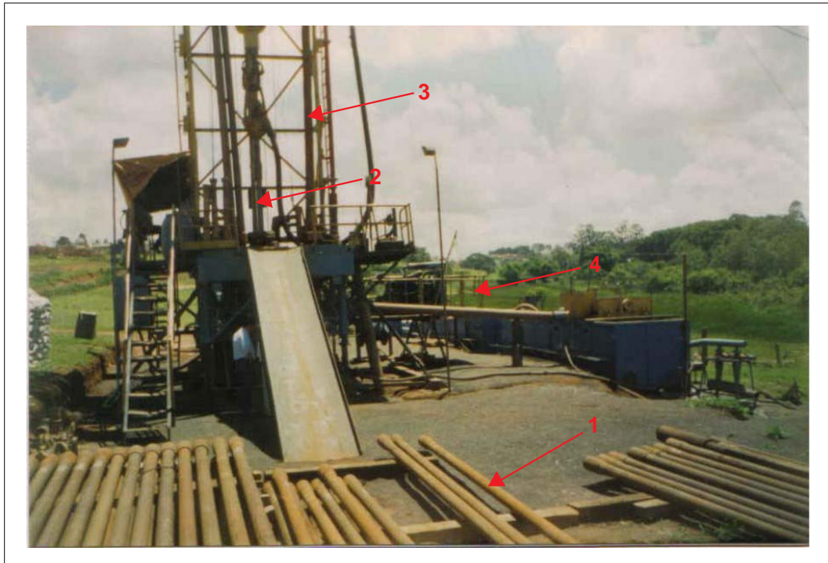
Figura 7.- Detalhes de instalação de uma sonda rotativa
