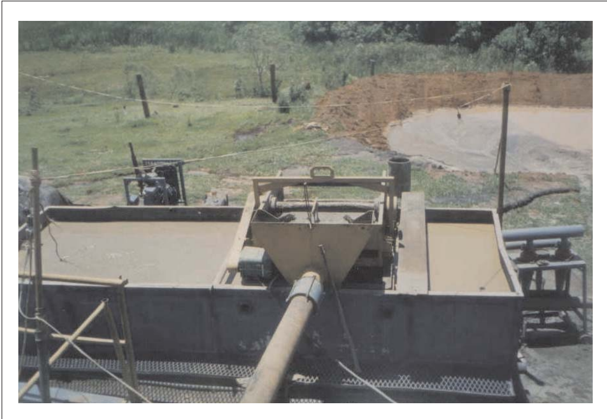
Figura 9.- Tanque de lama – peneira vibratória. Parte de um canteiro de obra – mostrando tanque de lama, com peneira vibratória.
