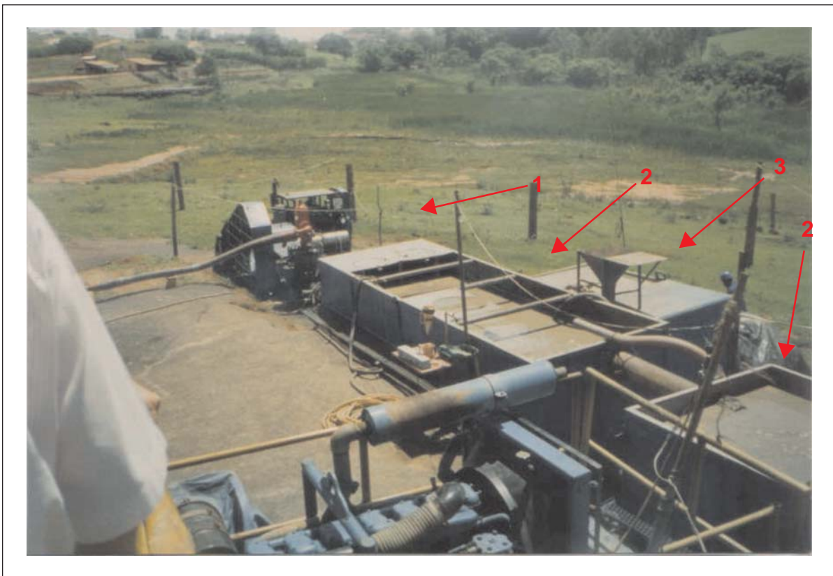
Figura 8.- Vista do circuito e tanques do fluido de perfuração
