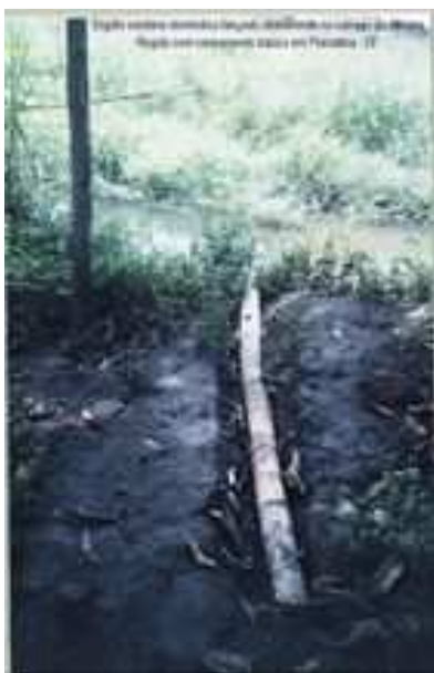
Figura 10 – ENCANAMENTO DESTINANDO EFLUENTES SANITÁRIOS PARA O CÓRREGO DO ATOLEIRO
