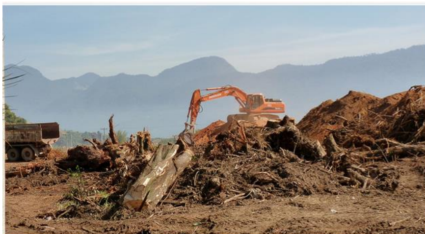
Figura 4: Decapeamento e retirada da cobertura vegetal no local a ser explorado. Fonte: CRAFT Engenharia, 2013.
