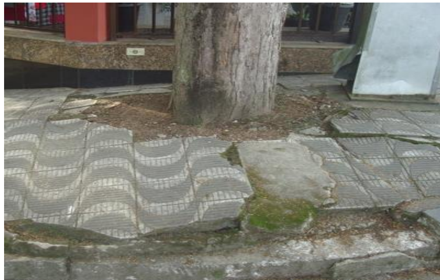
Figura 6: Sistema radicular de Poincianella pluviosa destruindo o passeio em rua do município de Vargem Alta, ES.
