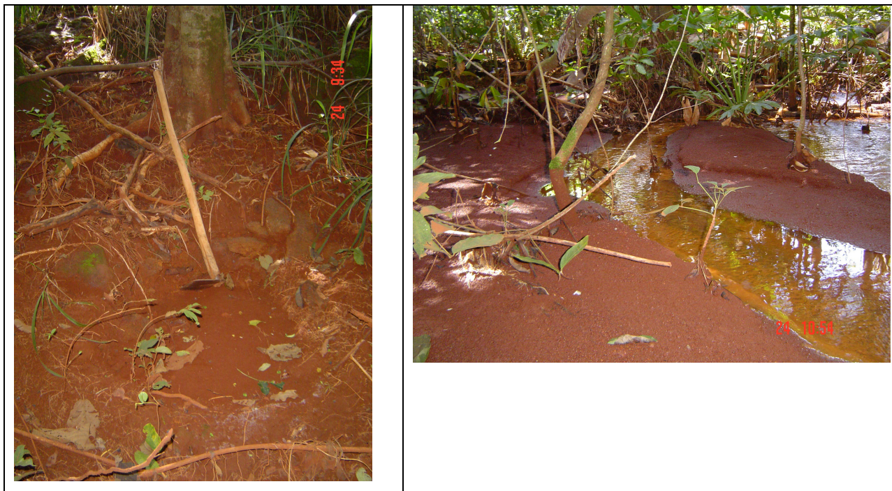
Figura 20 - a) Evidência de formação de sulcos de erosão dentro da área de mata ciliar; b) depósito de sedimentos na área alagada (vereda) a jusante d transeção 2.
