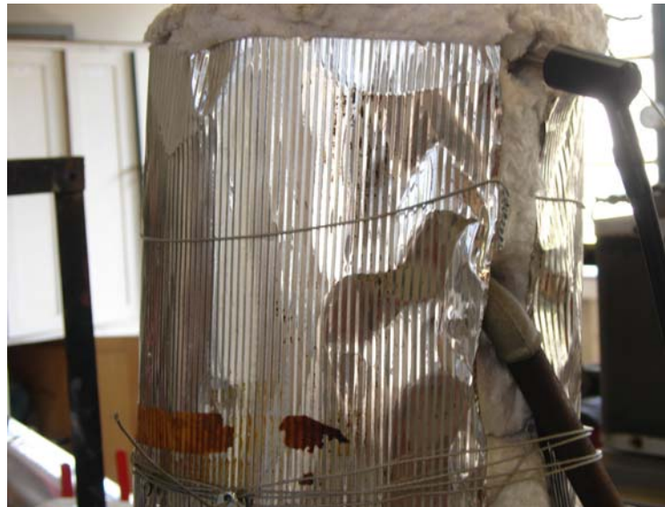
FIGURA 35 – POSIÇÃO DA SONDA DO ANALISADOR DE GASES NA CHAMINÉ DE TIRAGEM NATURAL
