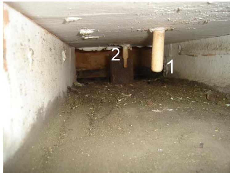
FIGURA 30 – INTERIOR DA CÂMARA DE COMBUSTÃO
