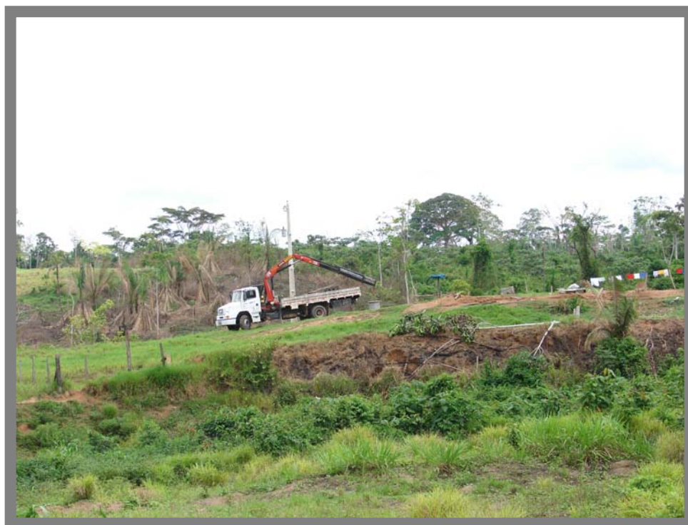
Figura 4. Instalação de energia elétrica na zona rural do município de Manoel Urbano-AC.
