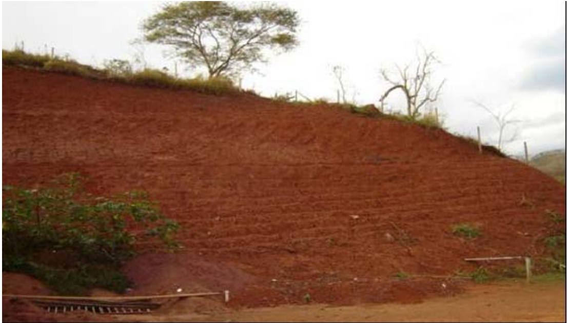
Figura 2 - Área experimental localizada no Campus da UFV, em frente ao Galpão de Triagem de Materiais Recicláveis (ASBEN), novembro de 2006.
