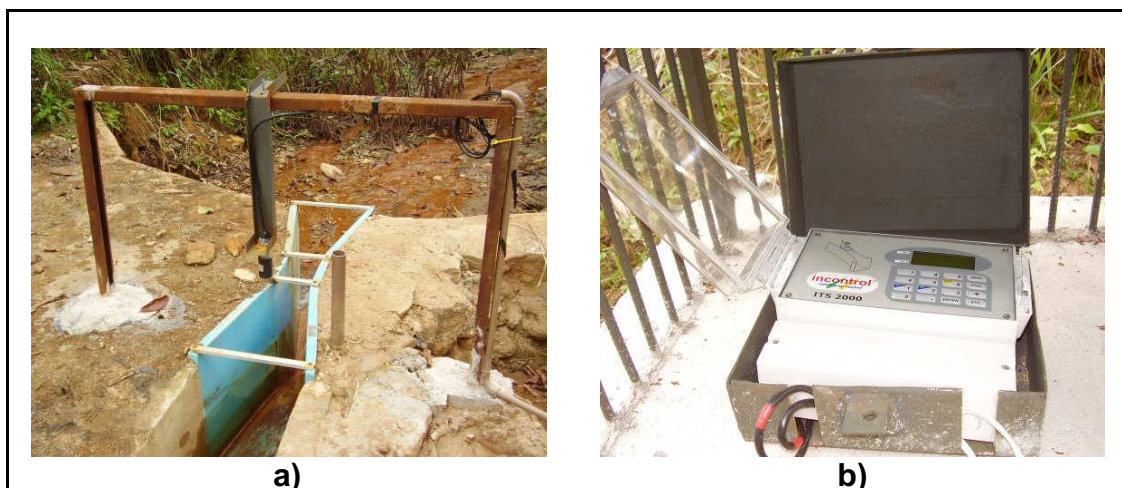
Figura 8 - a) Calha Parshall e sensor do ITS instalados na saída da BHCZ; b) ITS-2000 instalado junto a calha na Bacia Hidrográfica do Córrego Zerede, em Timóteo-MG, 2006.
