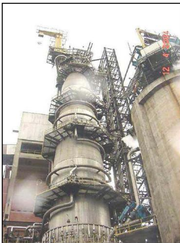
Figura 58: Digester 2 - Detalhe das circulações/extração
