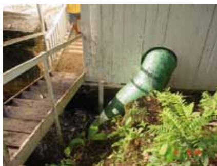
Casa de máquinas e tubo de sucção
