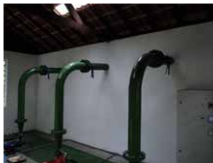
Válvulas antes das BFTs e três condutos
