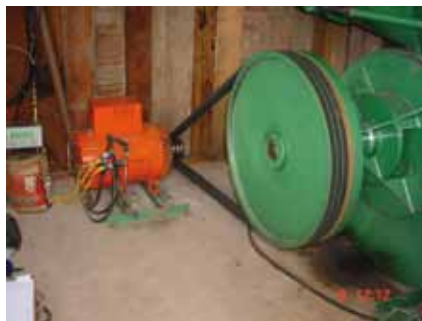
Acoplamento por polias e correias turbina gerador
