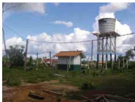
Micro-sistema de abastecimento de água
