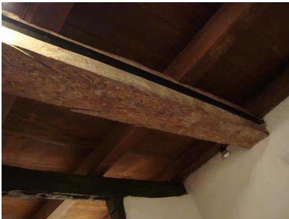
FIGURA 43 Aspectos das rupturas da viga do Sobrado Ramalho.
