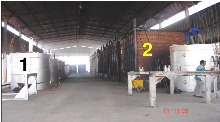
FIGURA 15: PRAÇA DE CARBONIZAÇÃO DA BIOMASSA: 1- CILINDRO METÁLICOS EM RESFRIAMENTO E 2- FORNOS DE CARBONIZAÇÃO.
