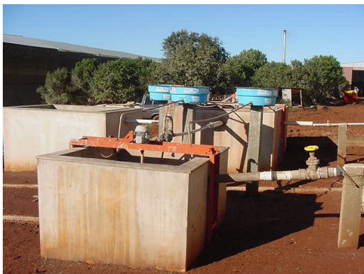
TANQUE DE DECANTAÇÃO FONTE: Pesquisa de campo
