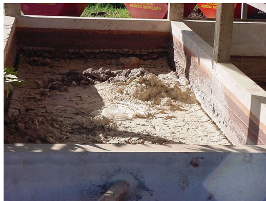
TANQUE DE LODO
