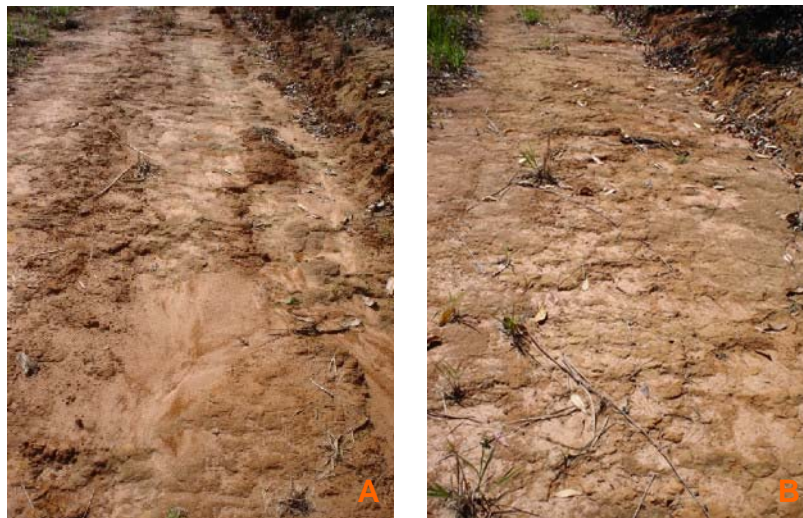
Figura 12 – Estrada 2 antes da passagem da motoniveladora (A) e 343 dias após (B)
