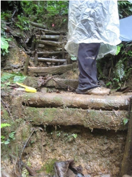
Figura 32 – Degraus altos e erosão na base
