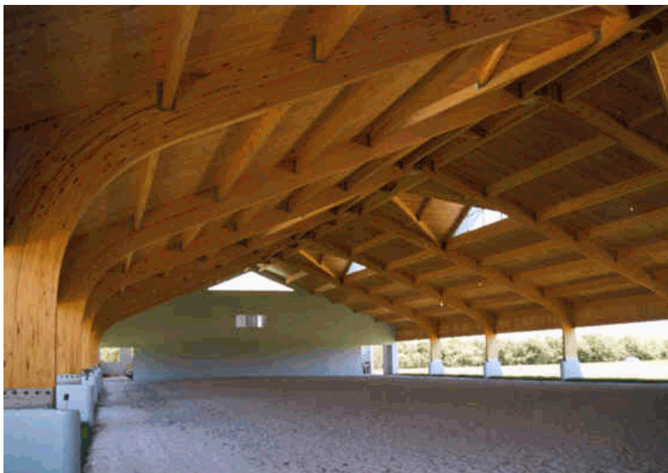
Figura 2 - Pórticos laminados colados utilizados como estrutura lateral e de cobertura de um galpão rural (Fonte: http://www.wheeler-con.com/ )
