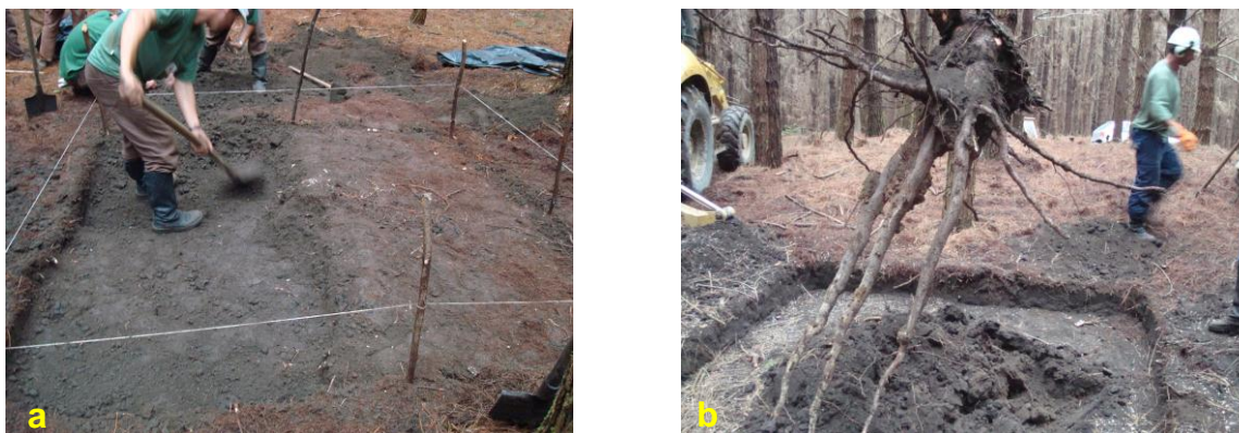
Figura 6 - Início da escavação manual da trincheira (a) e posterior retirada da raiz primária mais grossa com auxílio da retroescavadeira (b)
