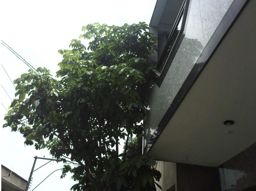
Figura 11 – Pachira aquática invadindo construção no bairro Dr. Gilberto Machado.
