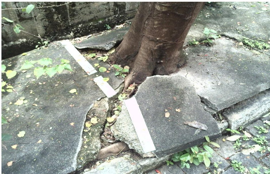
Figura 9 – Situação problema, encontrada na arborização viária de Cachoeiro do Itapemirim, onde um indivíduo da espécie Delonix regia (Flamboyant) causa a destruição do passeio.
