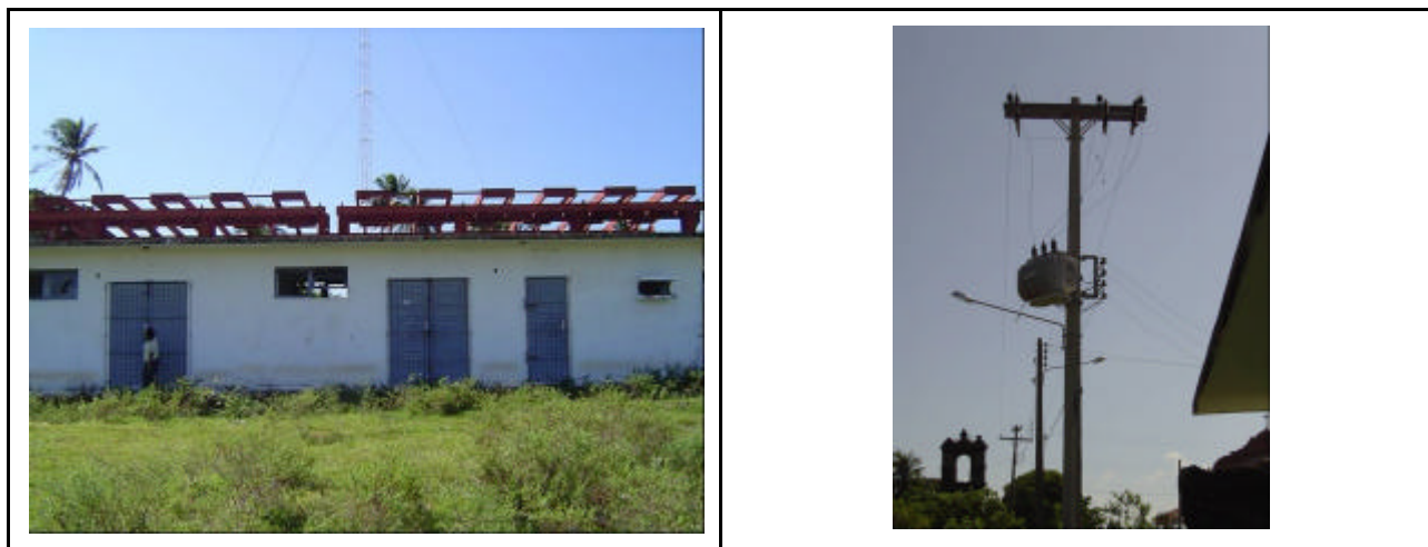
Figura 29 – Casa de força depredada e suportes de painéis fotovoltaicos vazios (esq.) e transformador elevador com cabos cortados (dir.)
