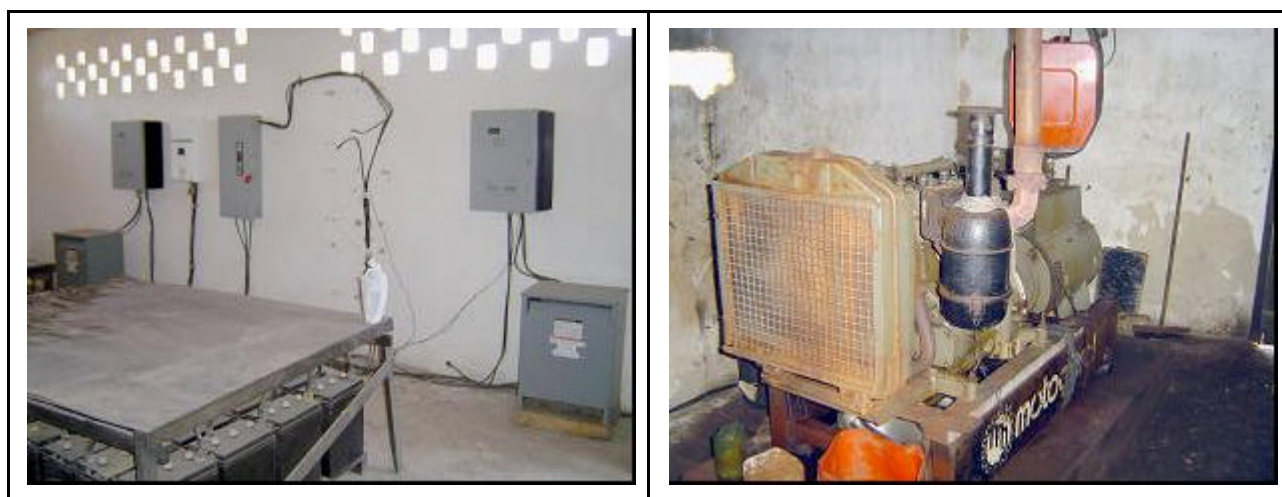
Figura 25 – Controladores de tensão e banco de bateria (esq.) e GMG diesel (dir.)
