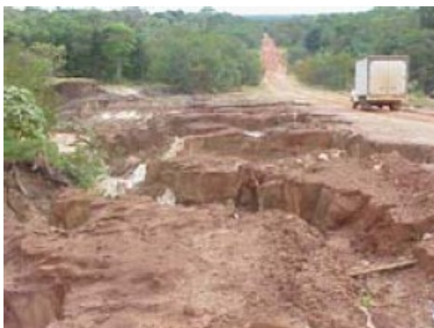
Foto 3 – BR-163: trecho Garantã do Norte, MT / Rurópolis, PA (precariedade da drenagem) Fonte: ECOPLAN (2002)
