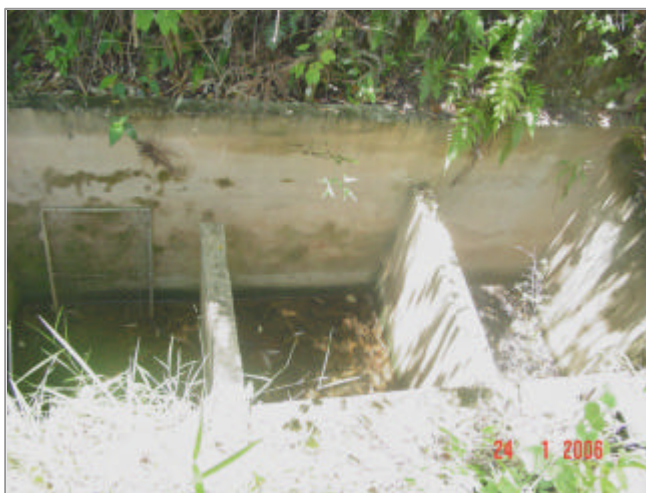
Figura 20: Vista do coletor de sedimentos vazio na voçoroca recuperada, contendo serapilheira e água, em 24 de janeiro de 2006, próximo à terceira avaliação.
