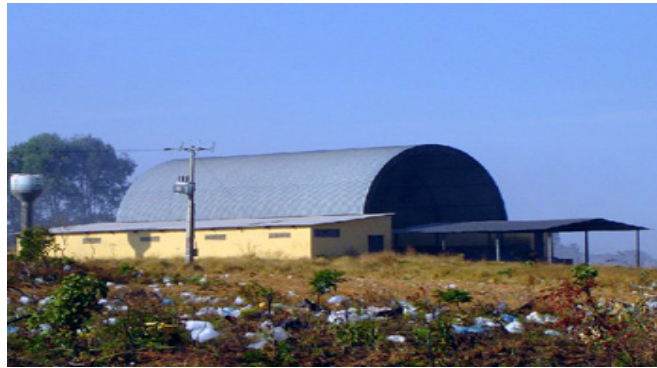
Ilustração 31 - Galpão para separação dos resíduos sólidos da cidade de Alto Paraíso de Goiás paralisado devido à falta de manutenção. Os resíduos sólidos também são, atualmente, queimados.
