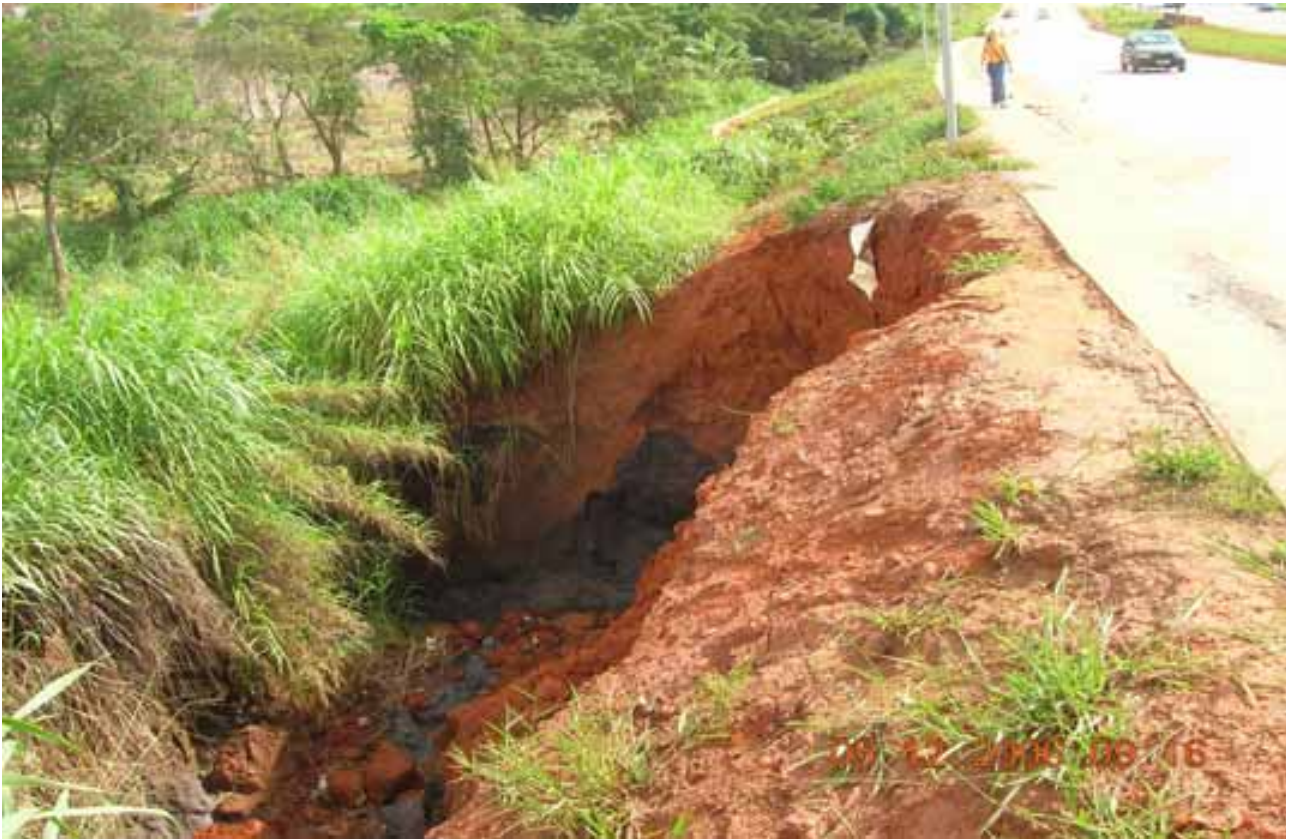
Figura nº. 13 – Foto de Processo Erosivo Avançado, Margens da EPTG Sentido Taguatinga
