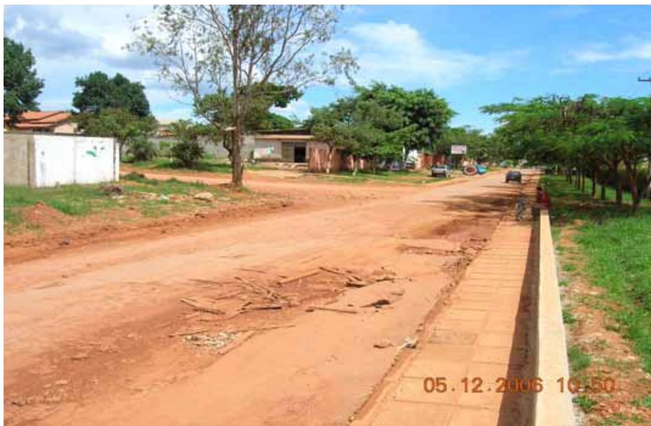
Figura nº. 15 – Foto Cruzamento da Rua 01-B com Rua 08, observando infra-estrutura precária
