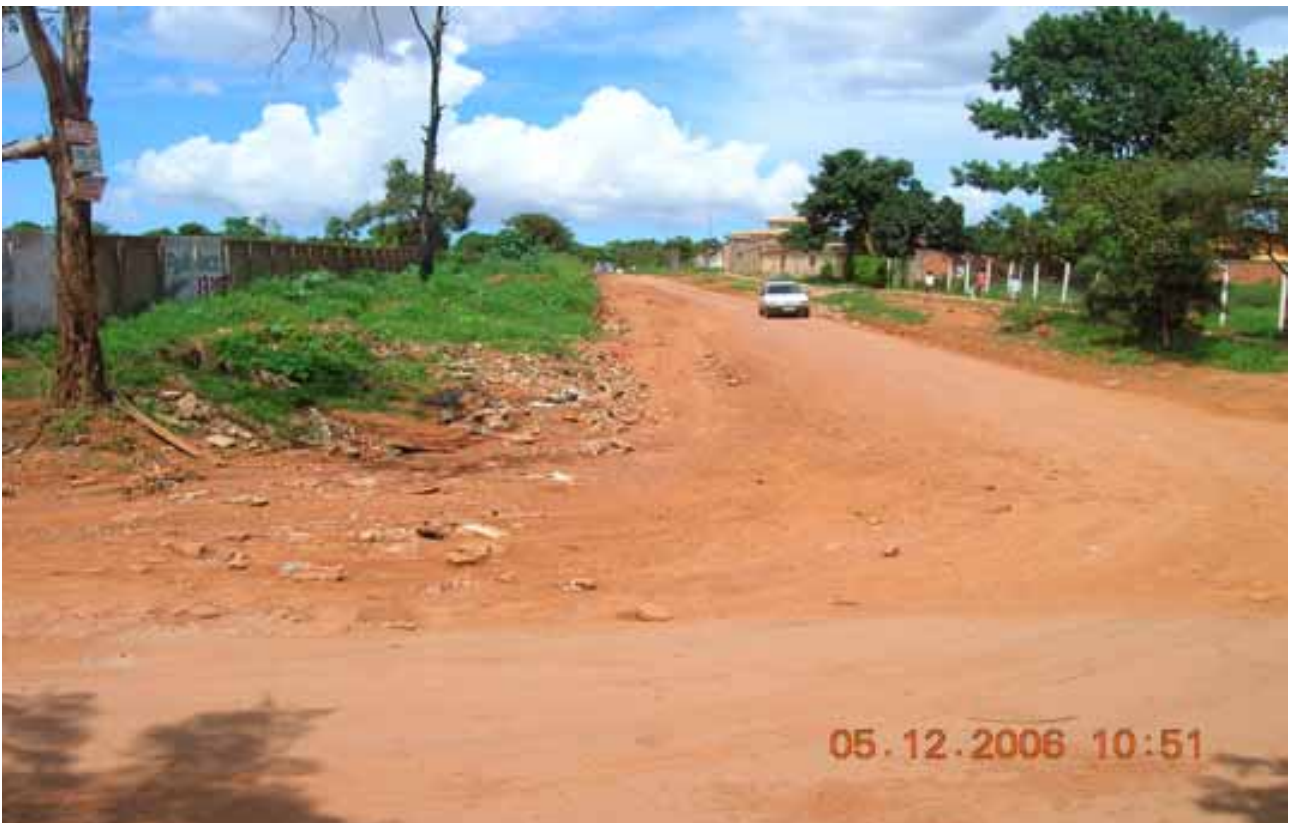
Figura nº. 14 – Foto de Início de Processo de Ravinamento, Rua 08
