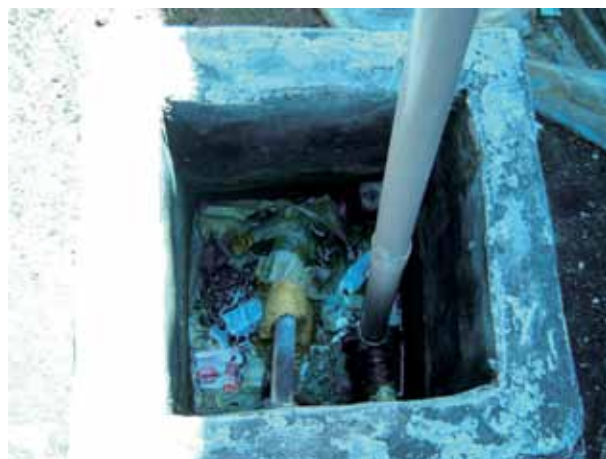
Foto 41: Lixo na área do sistema, sendo necessário um trabalho de conscientização do operador do sistema
