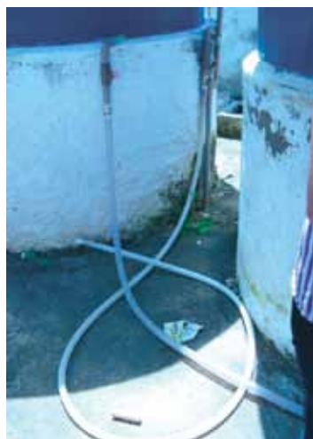
Foto 40: Mangueras utilizadas na distribuição de água dispostas de maneira inadequada
