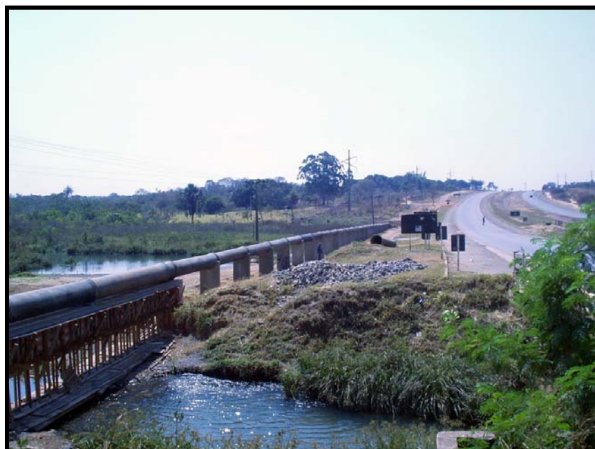
Figura 11. Fotografia da obra de porte médio, realizada durante o período de monitoramento do presente estudo, para construção de adutora da CAESB junto ao Córrego do Fumal, na rodovia BR-020.
